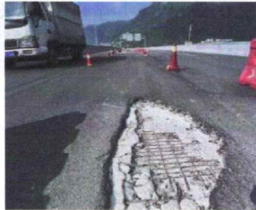
混凝土铺装碎裂
