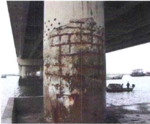
墩柱钢筋外露、锈蚀
